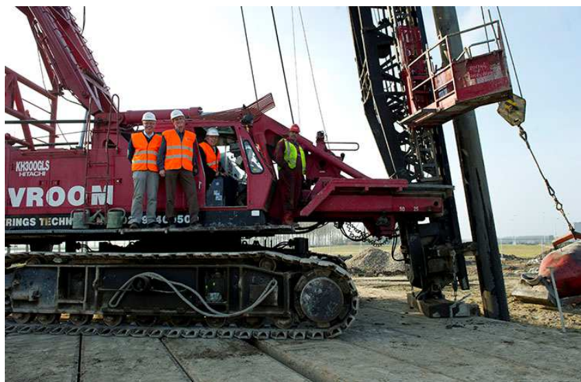
Het slaan van de eerste paal door de wethouder van milieu, Michiel van Liere in het bijzijn van Rick Wasser (Eneco) en Ernst van Zuijlen (Uwind) op 28 Februari 2013 (Foto: Eneco)
